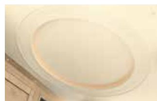
纖維加強板天花吊頂
